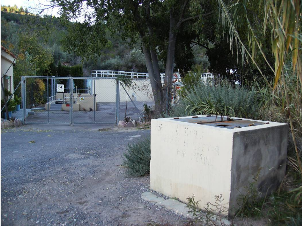
Pozo de bombeo, recoge las aguas de entrada a la EDAR
