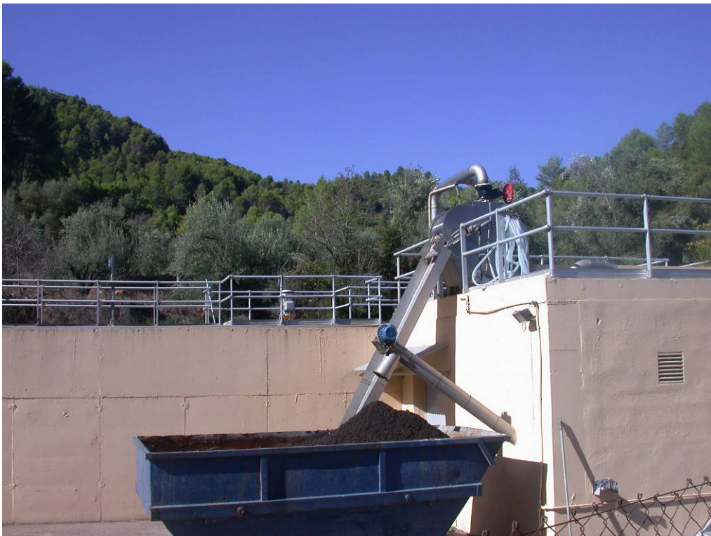
Tratamiento de fangos
